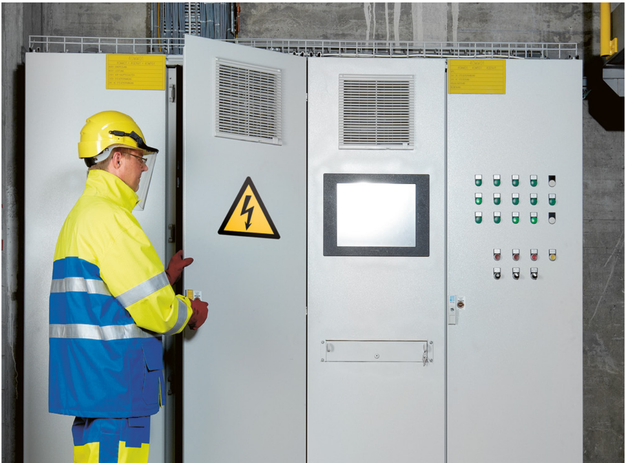
Bild 28 Mit Warnzeichen versehener Schaltschrank
